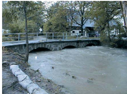
Abb. 2: Hochwasser Dezember 1995, Muhen. Fig. 2: Flood event in December 1995, Muhen.
