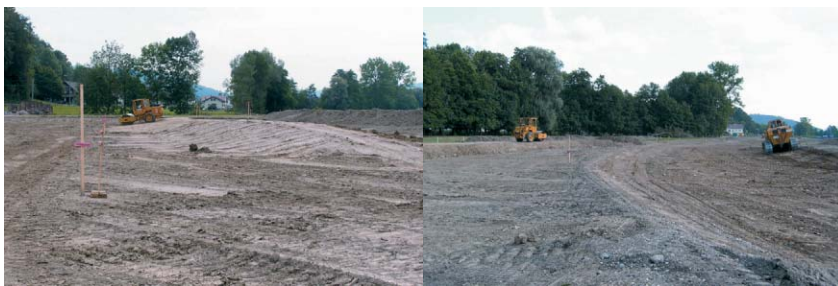
Abb. 12: Erdarbeiten am Entlastungsgerinne im Abschnitt Süd. Fig. 12: Earth construction work for the flood channel in section south.
