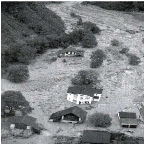
Abb1: Verwüstungen des oberen Dorfteils von Baltschieder durch Geschiebeablagerungen (Photo Walliser Bote /Rhône Verlag Visp)
