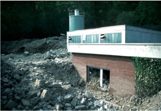
Abb. 4: Verschüttete Gebäude und Anlagen des Klärwerks im Fuldata nach dem Abflussereignis im April 1994 Fig. 4: Damaged buildings and works of the Fuldata sewage plant after the runoff event on April 1994
