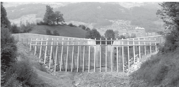
Abb. 7: Breiter Grobholzrechen im Geschiebesammler am Edisriedbach bei Sachseln (Kanton Obwalden).
