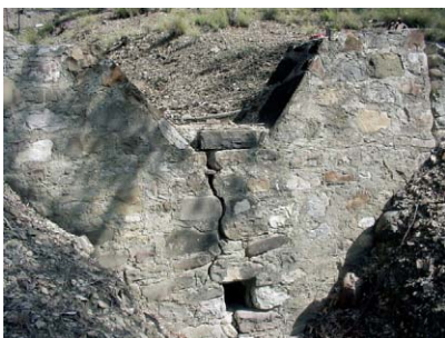
Fig. 8 - Briglia in pietra e malta con fessurazioni Fig. 8 - Stone masonry check dam with crackings
