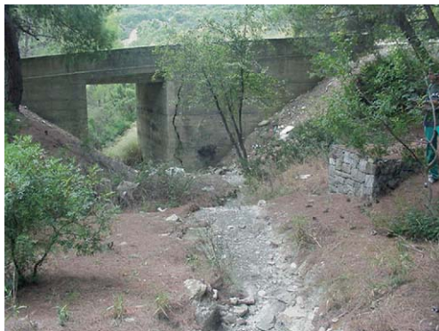
Fig. 9 – Manufatto di attraversamento stradale lesionato
