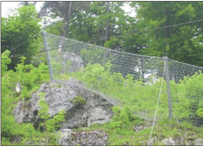
Abb1: flexible Schutzverbauung gegen Steinschlag
