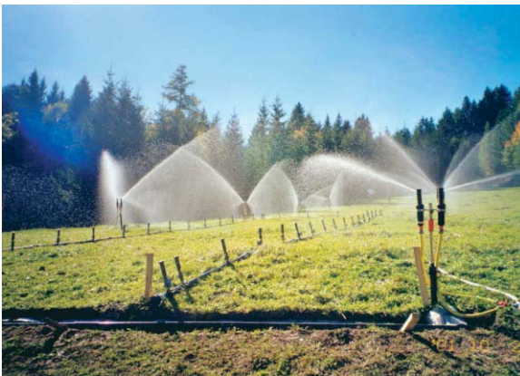
Abb. 3: Beregnungsanlage für geringe Intensitäten (Bauart BFW Innsbruck)
