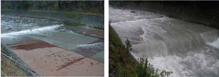
Abb. 3, 4: Abflussmessstation Schächen-Bürglen mit dem Pneumatikmessprofil und der Vorschwelle bei Niedrigwasserabfluss (Bild links) und bei einem kleineren Hochwasser (Bild rechts).
