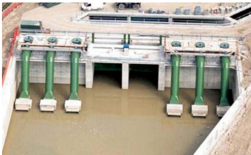
Fig. 7: Tubazioni di scarico delle idrovore
